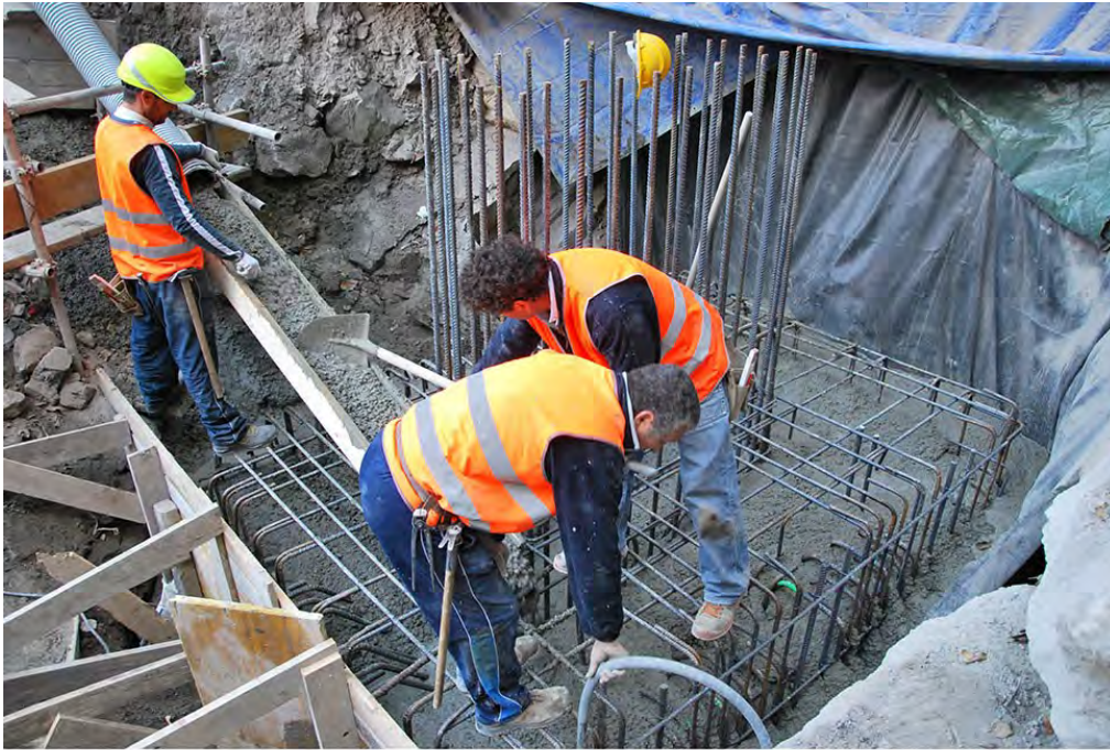
Fontanassa 16.11.2015 - viaggio dopo viaggio col treno cantiere e la piccola betoniera la cassaforma va riempiendosi. Al terzo viaggio la fondazione è quasi completata. In primo piano l'addetto al vibratore. La vibrazione del conglomerato cementizio durante la gettata è operazione di grande importanza: scongiura il trattenimento di bolle d'aria che indebolirebbero la struttura.
